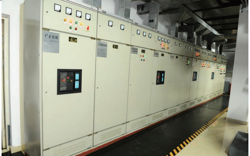
地能热泵环境系统主机柜
