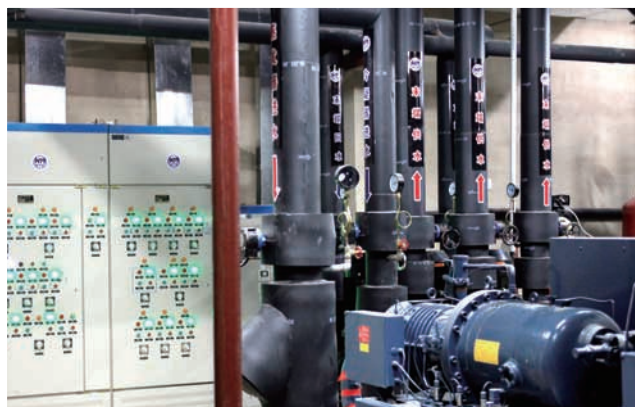
▼ 图为恒有源地能热泵环境系统机房
