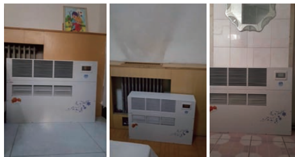
室内机安装于客厅、卧室、卫生间
