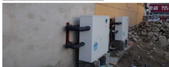
改造后热泵主机(安装于室外)
