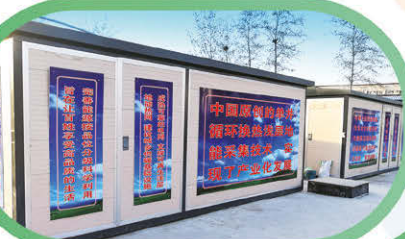
高效電替煤集中供暖機房
